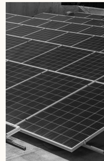
▲ Instalacje paneli słonecznych
